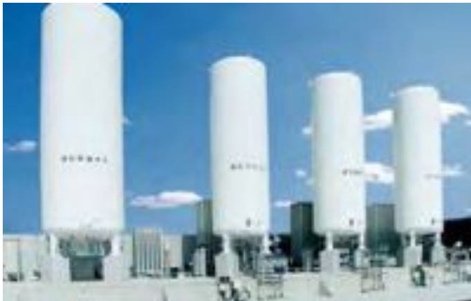
超低温液化ガス貯槽 C E (コールドエバポレーター)
